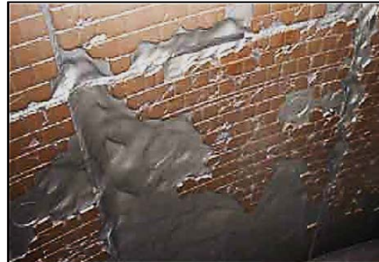
Paredes del pulverizador dañadas.
